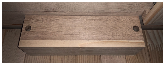
Zakrytý spoj káblov
